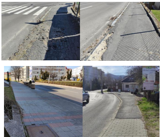
Obr. 1.15.2 Rôzny stav a povrchy chodníkov v Banskej Bystrici
