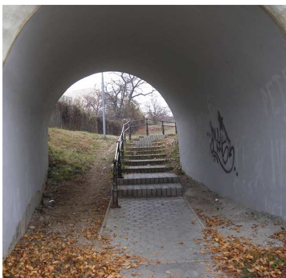
Ul. Pod Jesenským vrškom – chýbajúca rampa
